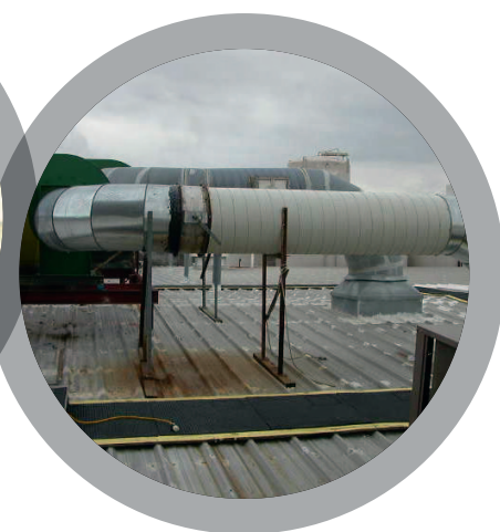
Conduits de climatisation
